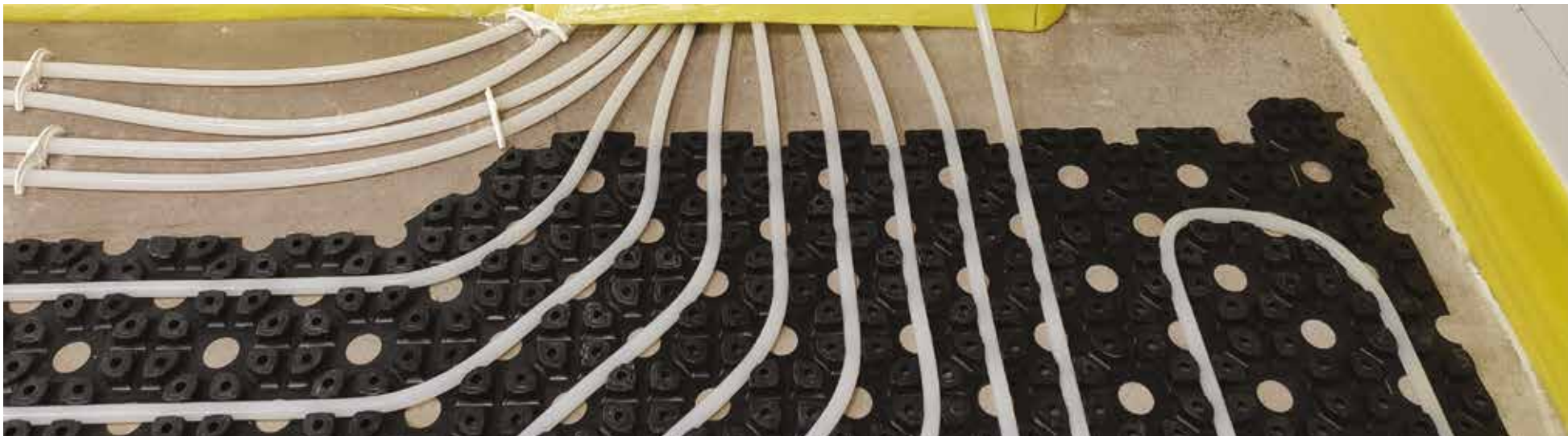
Rohrzuleitung zum Verteilerkasten Provision of pipes to manifold cabinet
